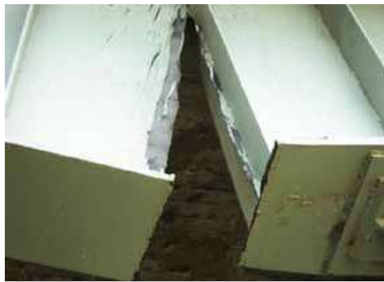
Acercamiento en la zona de fractura
